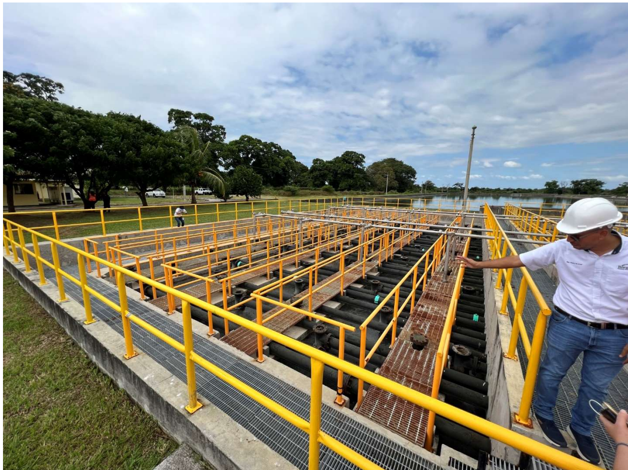
Figura 7: Reactor UASB de la PTAR de Granada, Nicaragua
