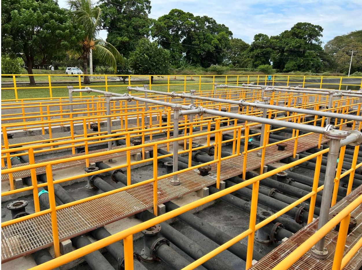
Figura 8: Tuberías de distribución de aguas y recolección de gas del UASB, PTAR Granada, Nicaragua
