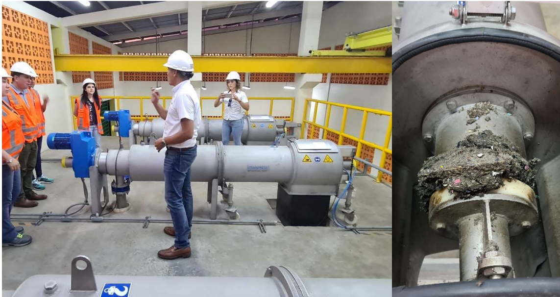
Figura 3: Equipo de espesamiento mecánico
