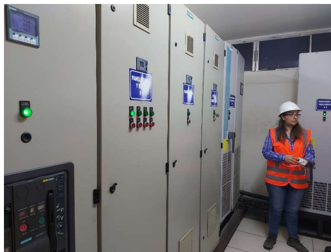
Figura 5. Paneles de control, estación elevadora
