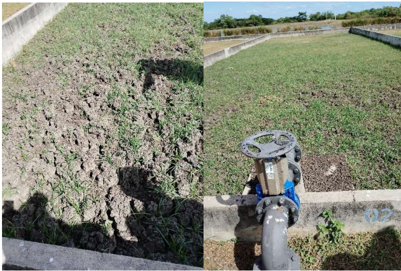
Figura 11: Lechos de secado de lodo digerido
