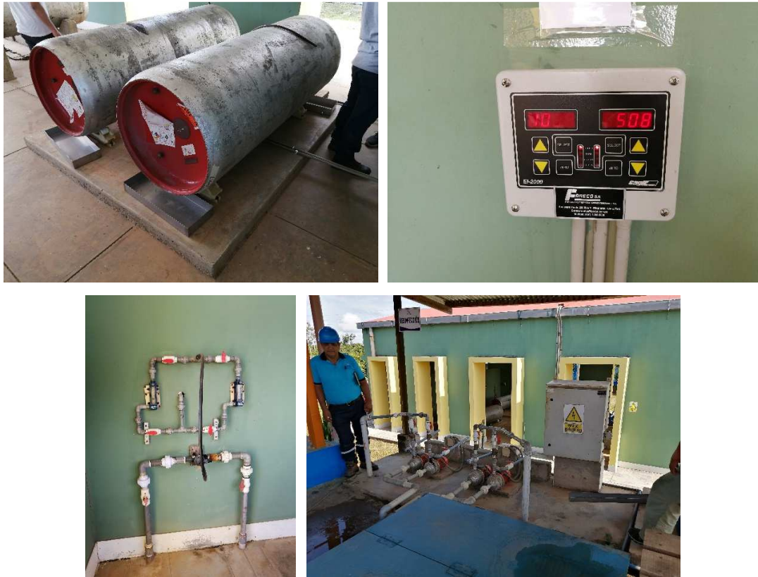
Imagen 7. Equipamiento para desinfección mediante gas cloro. Fuente: propia
