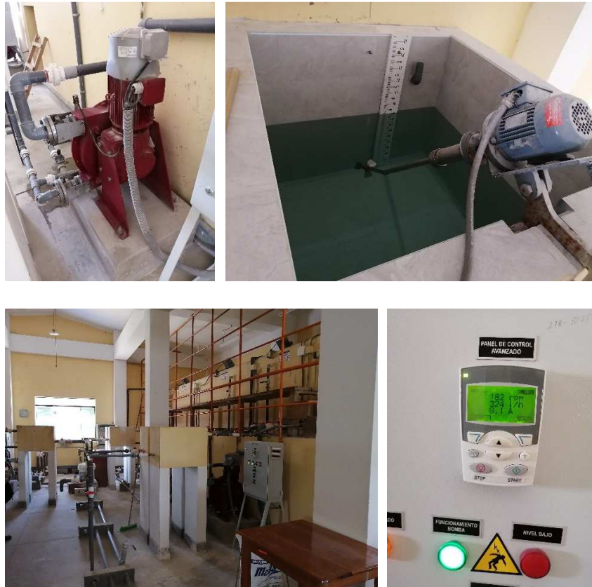
Imagen 7. Tolvas para la preparación de reactivos químicos y equipos de dosificación. Fuente: propia
