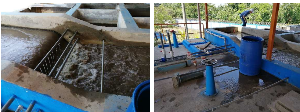
Imagen 3. Salto hidráulico y tuberías de dosificación de reactivos químicos Fuente: propia
