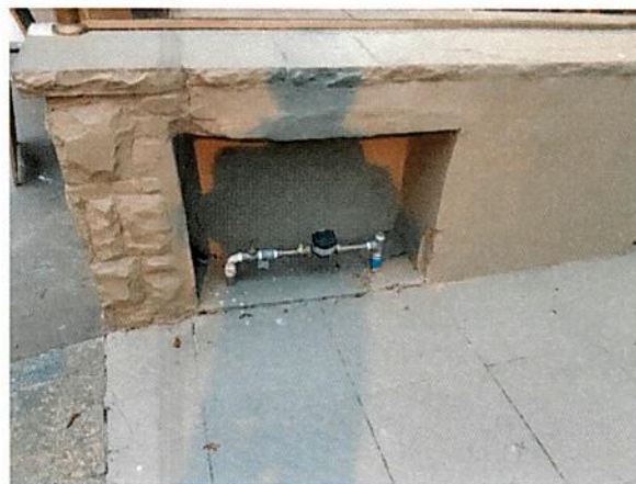
Fig No 7: Instalación real de u hidrómentro en Sao Paulo
