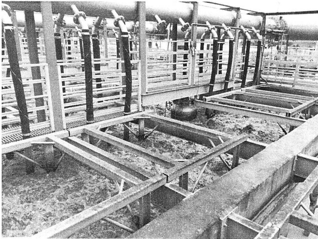
Figura 7 Reactor tipo MBR de la estación de reuso ABC/Aquapolo.
