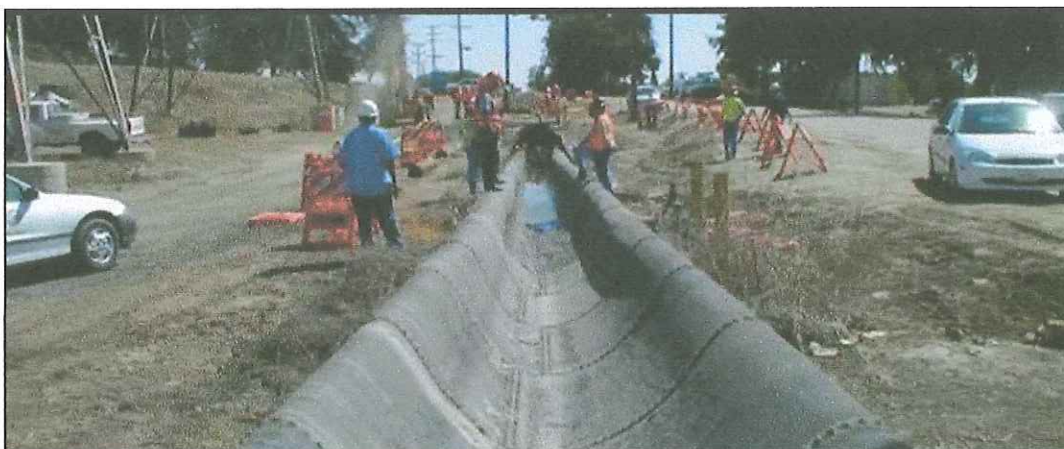
Figura 3. Falla por aplastamiento en una tubería de acero
