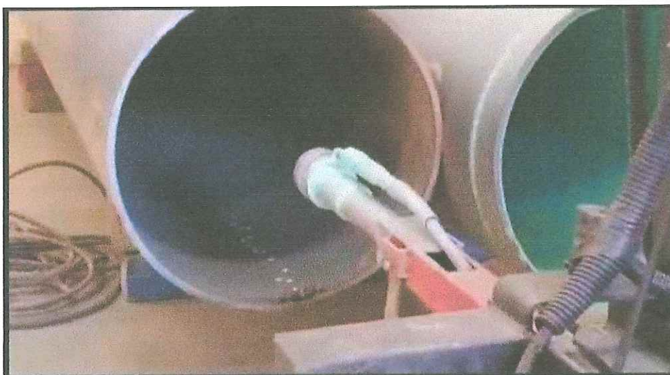
Figura 14. Aplicación del revestimiento interno de mortero-cemento. Fuente: Material suministrado en la Academia PAM Latinoamérica 2017.
