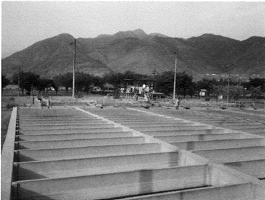
Figura 8. Vista de los floculadores y al fondo los seis Parshall
