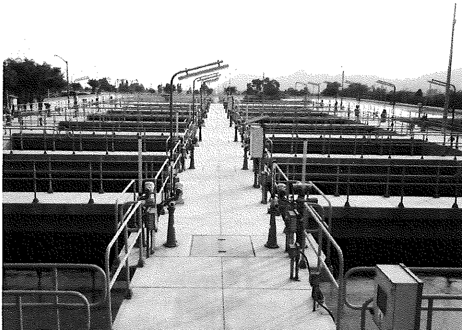
Figura 10. Vista de la batería de filtros
