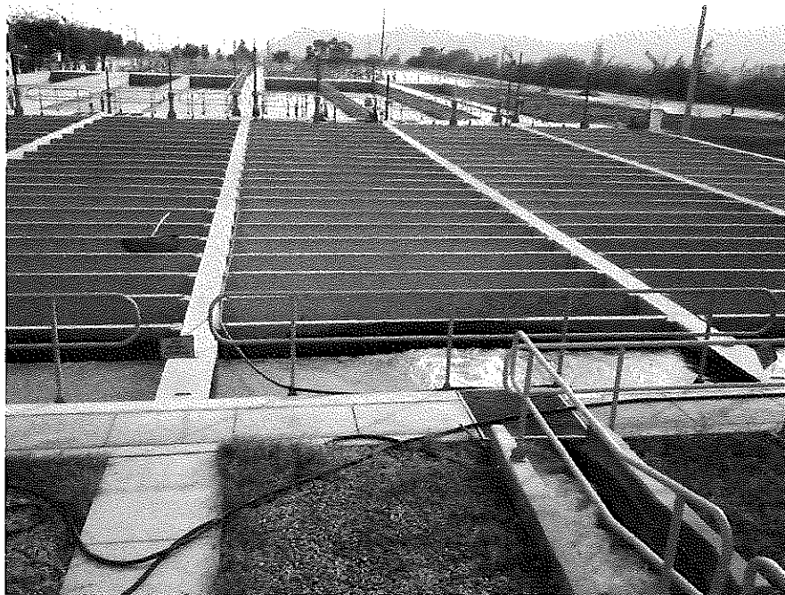
Figura 6. Vista de entrada agua a floculadores
