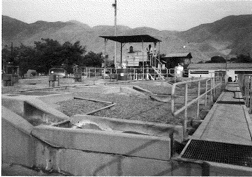
Figura 1. Vista lateral de los seis canales de ingreso Parshall hacia la planta
