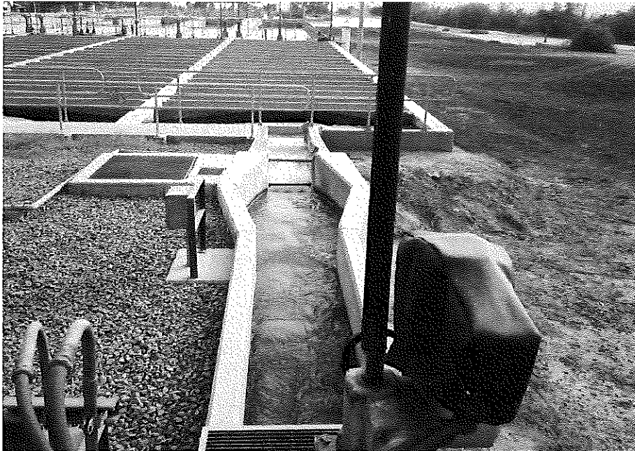
Figura 2. Canal Parshall con un flujo promedio de 635 l/s
