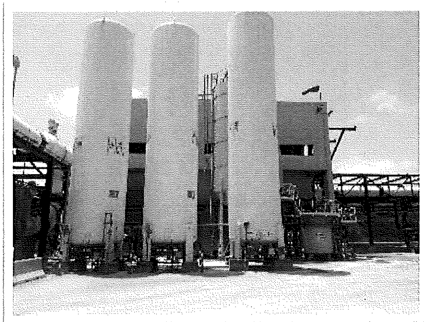
Imagen #8: Tanques de almacenamiento de CO 2 . Planta de Hadera
